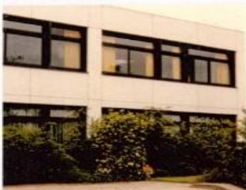
eintönige Fassade, dunkle Fensterrahmen, keine Isolierung
